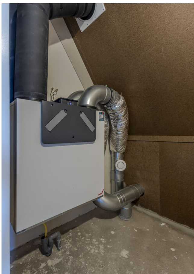
Technische ruimte met balansventilatiesysteem
