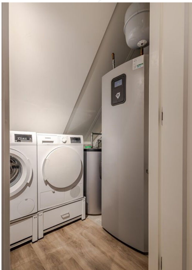
Technische ruimte / wasruimte
