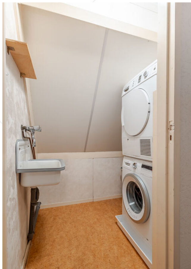
technische ruimte 2e verdieping
