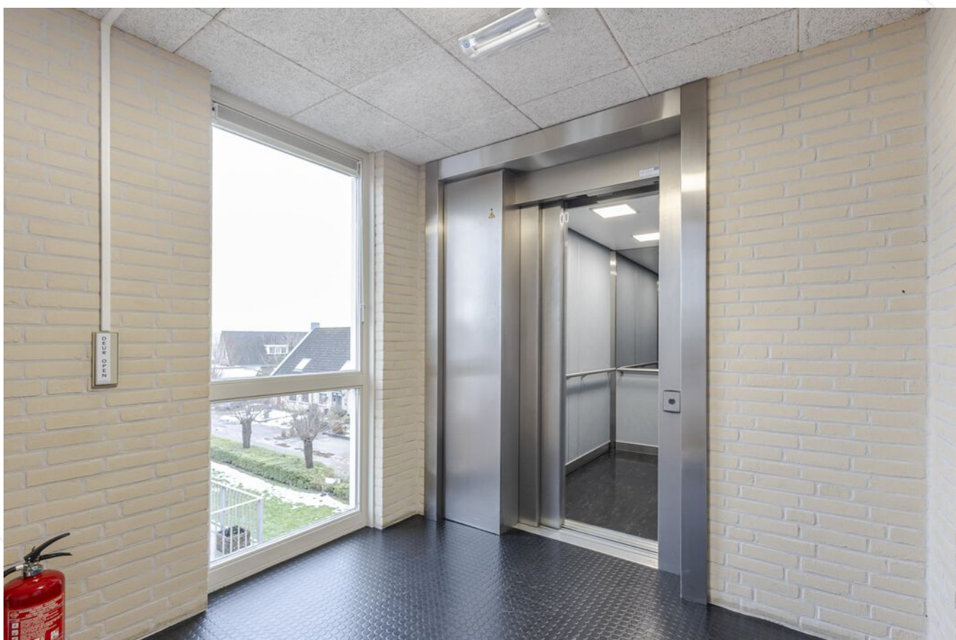
Centrale hal met liftinstallatie
