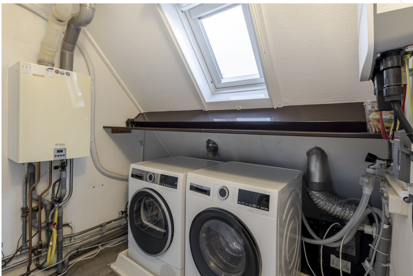
Wasruimte met c.v.-opstelling
