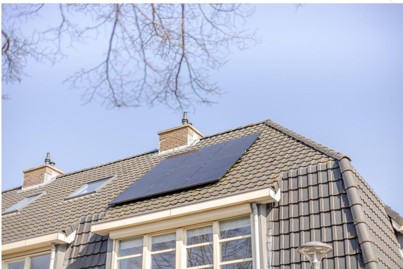
Zonnepanelen op het dak
