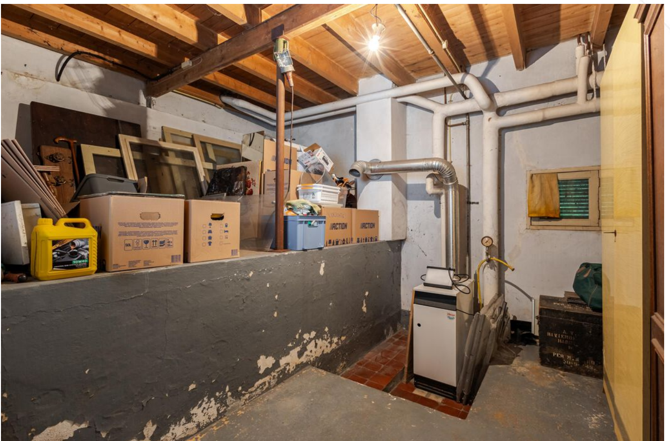
Technische ruimte / opslag
