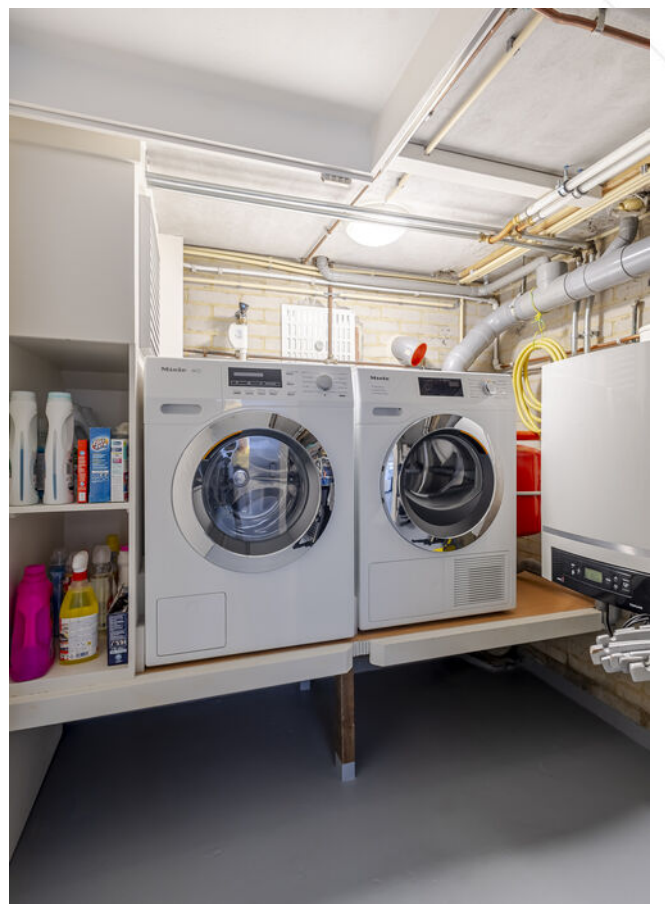
Witgoedaansluiting + cv-opstelling in grote (schuifwand)kast
