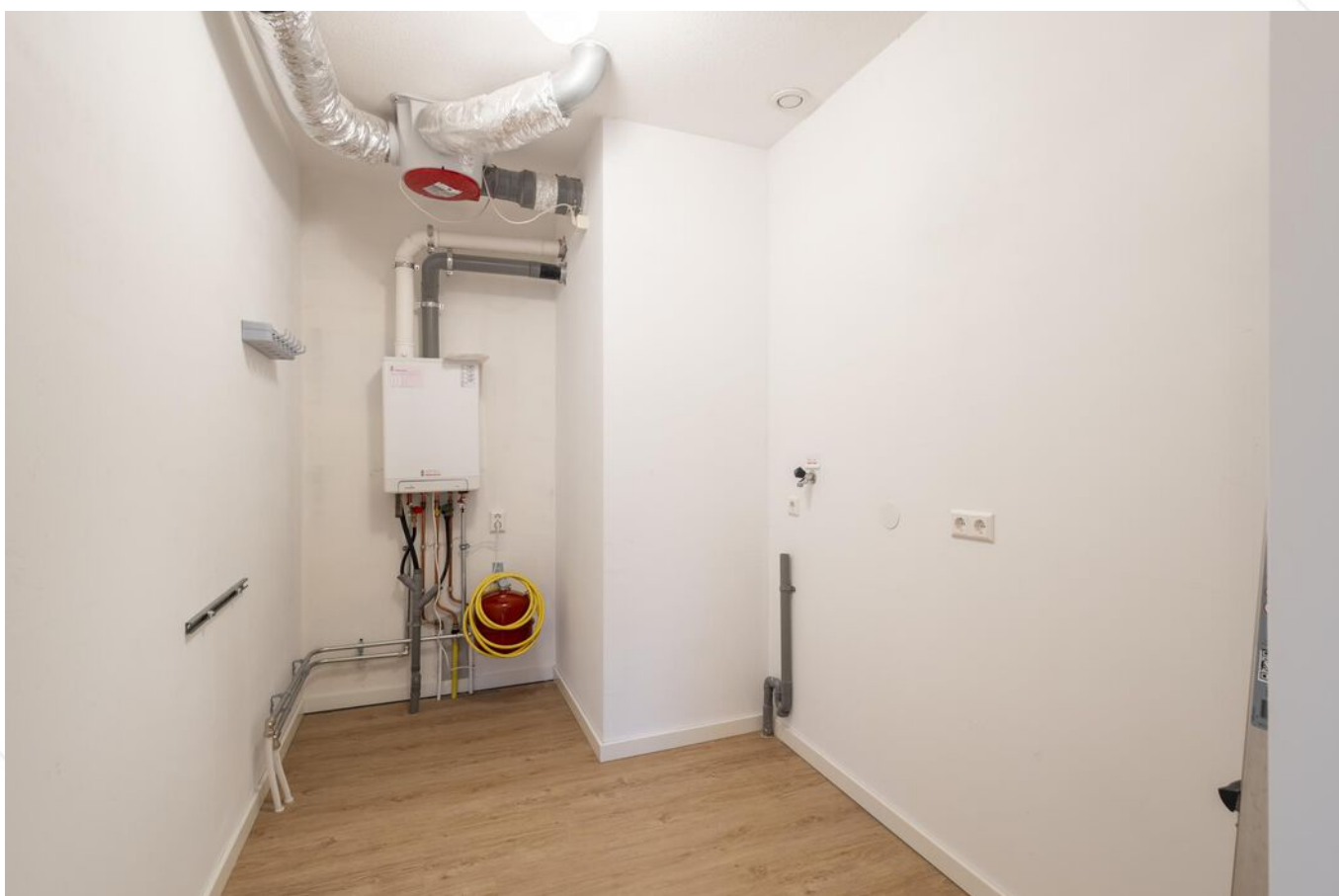
Technische ruimte/inpandige berging
