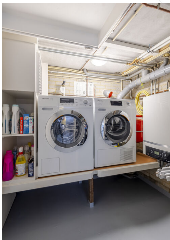
Witgoedaansluiting + cv-opstelling in grote (schuifwand)kast
