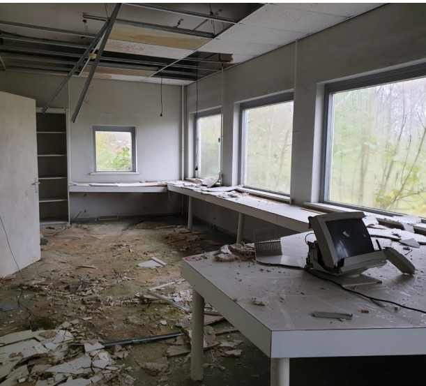
Slechte staat van het kantoorgebouw
